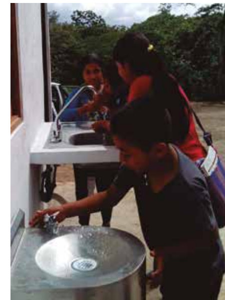
Estación de Agua Segura, San Juan Cancuc.
